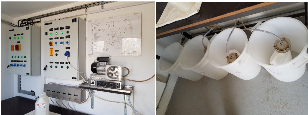
Slika 1.2: Avtomatska vzorčevalna postaja HE Brežice (7,2 km nizvodno od NEK), kjer poteka neprekinjen zajem vzorcev vode.
