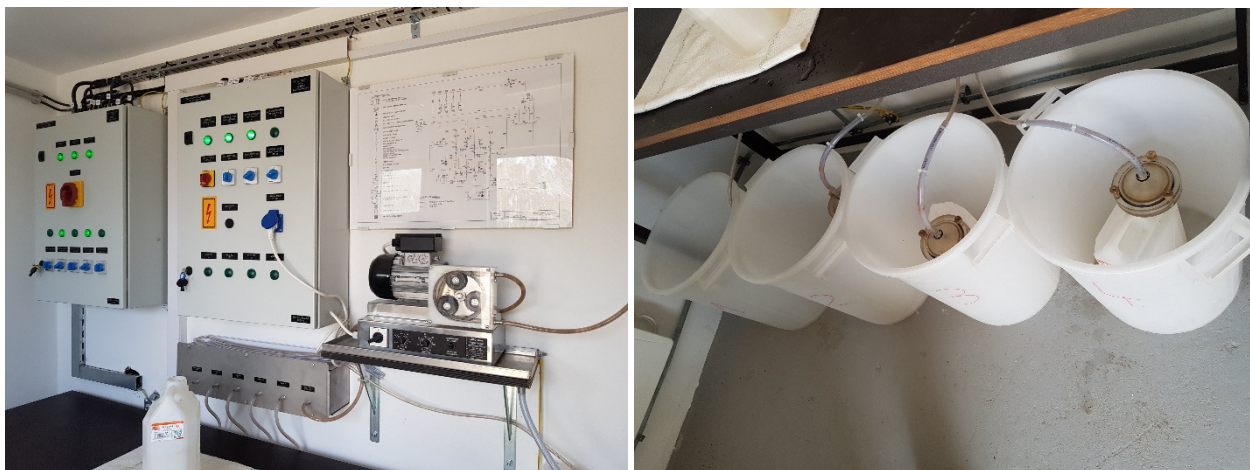
Slika 1.3: Avtomatska vzorčevalna postaja HE Brežice (7,2 km nizvodno od NEK), kjer poteka neprekinjen zajem vzorcev vode
